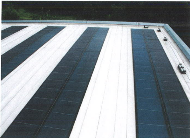
1. kép Tetőszigetelés felületére kasirozott napelem
