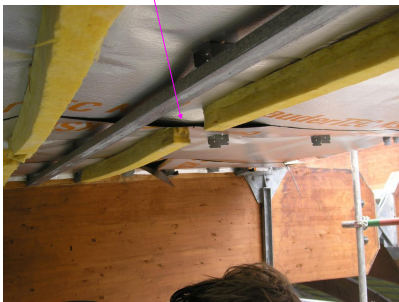
Párazáró bitumenes lemez elvált
