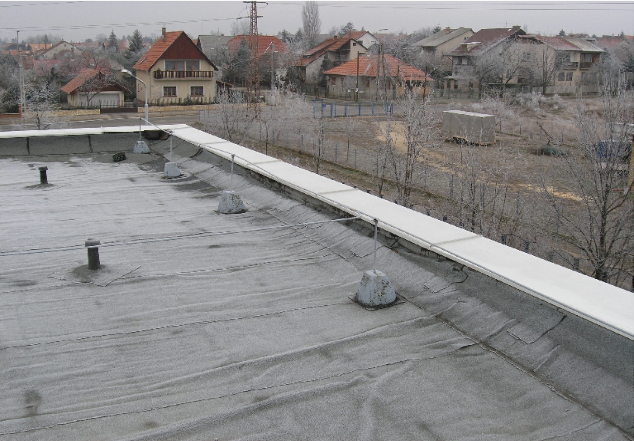
A KÚSZÁS JELENSÉGE: OXIDBITUMENES RAGASZTÓ + POLISZTIROLHAB HŐSZIG.
